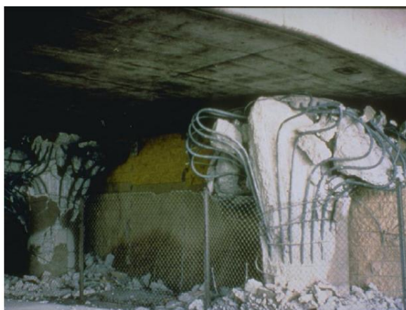
Fig. 2.6 – Sismo de Northridge (1994, EUA). Armadura transversal insuficiente.
