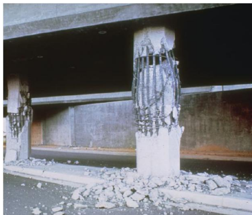
Fig. 2.7 – Sismo de San Fernando (1971, EUA). Sub-dimensionamento de armadura transversal.
