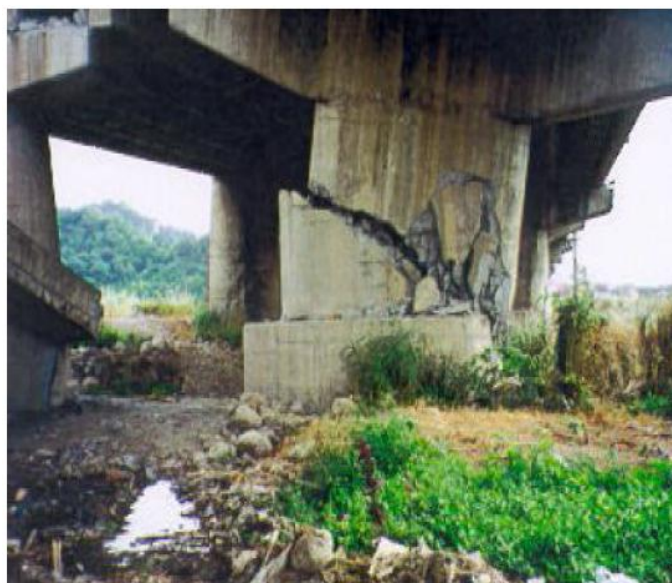
Fig. 2.9 – Sismo em Taiwan (1999). Rotura frágil por corte.
