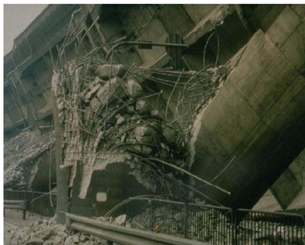
Fig. 2.3 – Sismo de Kobe (1995, Japão). Dispensa prematura de armadura longitudinal.
