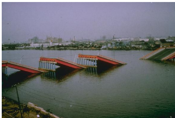
Fig. 2.1 – “Showa Bridge”, Niigata (1964). Colapso por rotação dos pilares devido a liquefacção.
