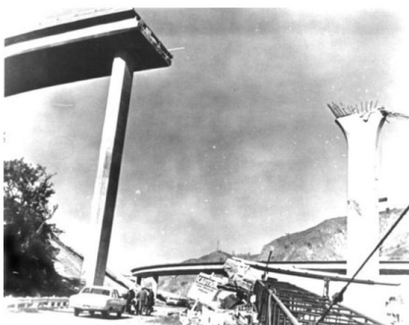
Fig. 2.10 – Sismo de San Fernando (1971). Queda de tabuleiro.
