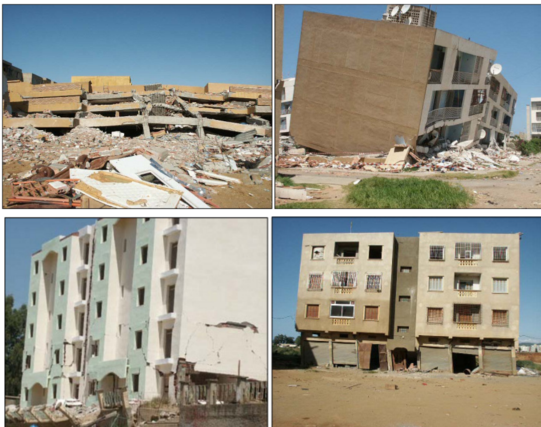
Fig.3.2 – Danos estruturais causados pelo sismo (EERI, 2003)
