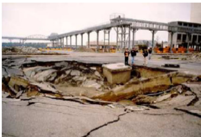
Fig.2.6 – Liquefacção resultante do sismo de Chi Chi, 1999 (adaptado de Fonseca, 2009).
