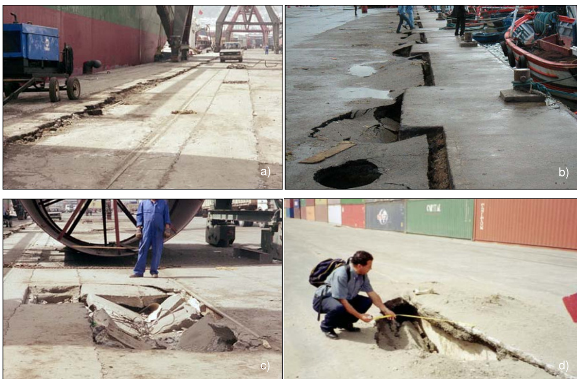
Fig.3.7 – a) e b) Assentamentos diferenciais no cais de Alger; c) e d) Cavidades devidas à liquefacção (EERI, 2003)
