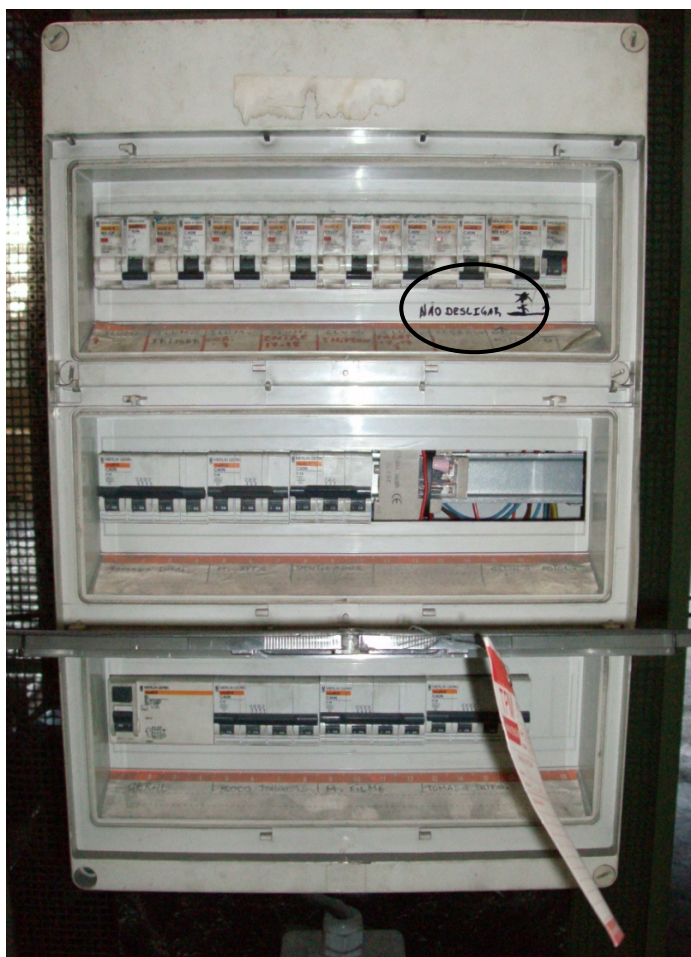
Figura 19 – Situação anterior dos quadros eléctricos da iluminação
