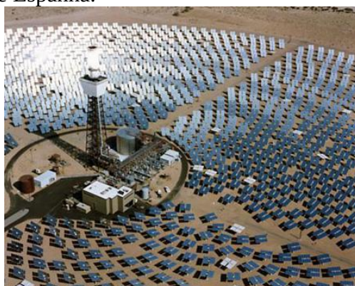
Figura 3.6: Central de torre - Solar Two, deserto Mojave, Califórnia
