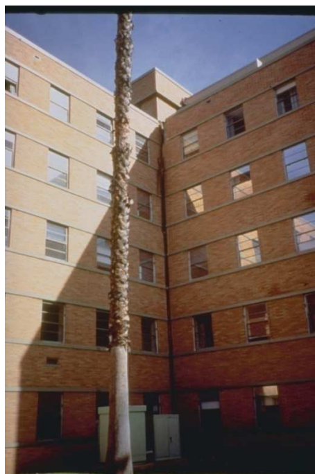
Figura 2.5 – Exemplo 2 do fenómeno de Pounding ocorrido na Califórnia em 1997 (National Geofisical Data Center, 2007)
