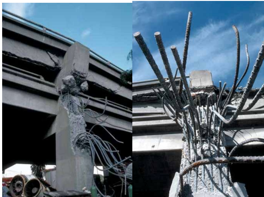
Fig. 2.8 – Falha dos nós de ligação (pormenores)[6].
