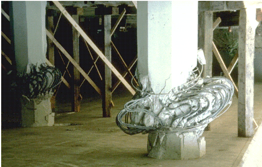
Fig. 2.1 – Rotura do pilar por flexão devido a ductilidade insuficiente [3].
