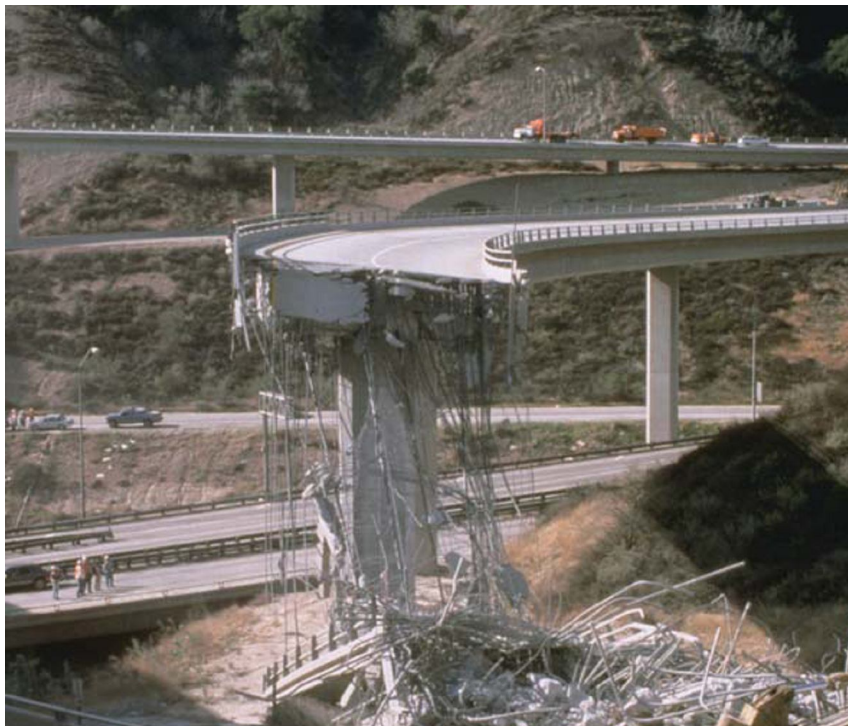
Fig. 2.5 – Queda do tramo de um tabuleiro por falta de apoio [6].
