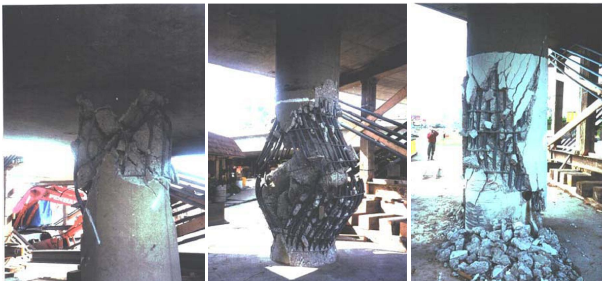
Fig. 2.3 – Rotura por esforço transversal em diferentes zonas de pilares [5].
