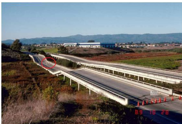
Fig. 2.6 – Falha do tabuleiro por punçoamento na zona dos pilares [6].
