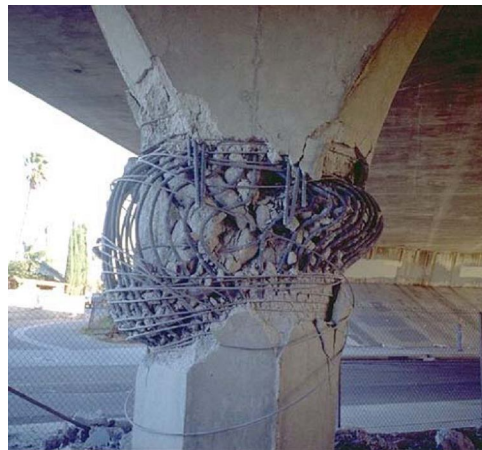
Fig. 2.2 – Rotura do pilar na zona de variação das dimensões da secção [4].
