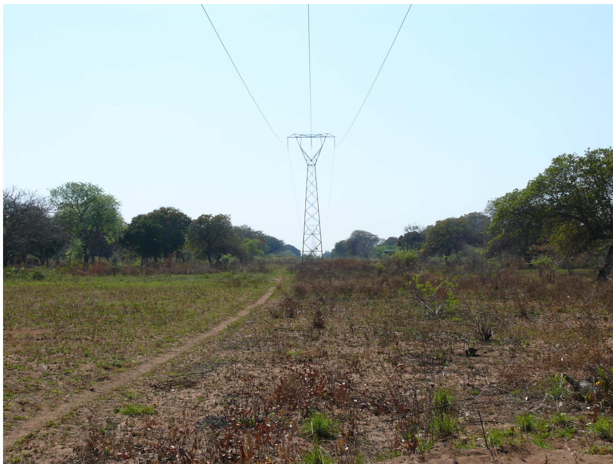
Fig.25 – Linhas eléctricas que passam pelo bairro, sua zona alta da machamba (Arquivo pessoal do autor)
