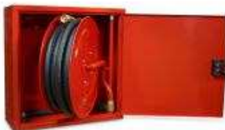
Fig.3 – Boca-de-incêndio do tipo carretel em armário
