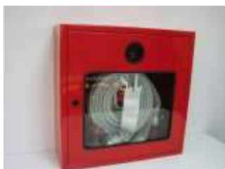
Fig.4 – Boca-de-incêndio do tipo teatro
