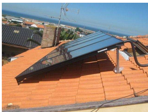
Fig.2.36 – Colector fixado por suportes na Cobertura [47].
