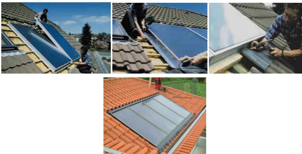
Fig.2.35 – Colector integrado na Cobertura [16].
