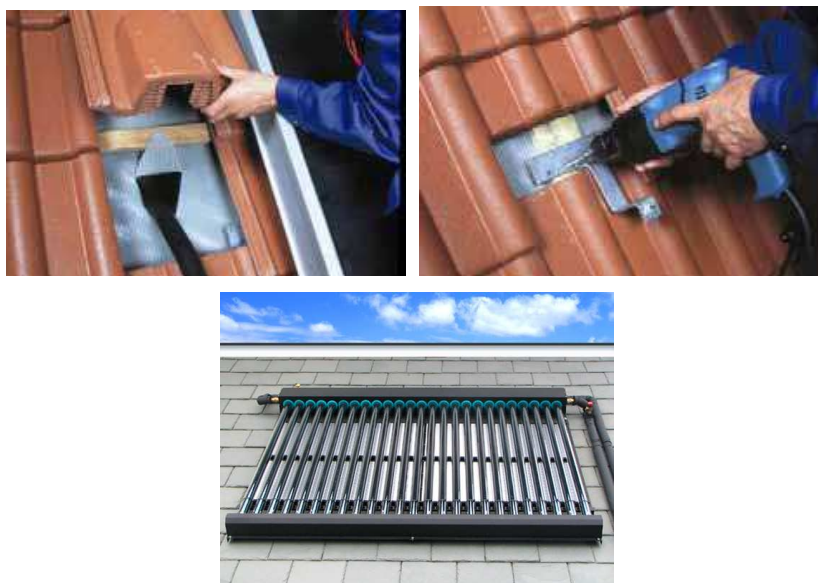
Fig.2.34 – Colector montado sobre a Cobertura [16].
