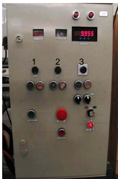
Figura 3.62 – Quadro eléctrico dos ensaios hidráulicos de geossintéticos.
