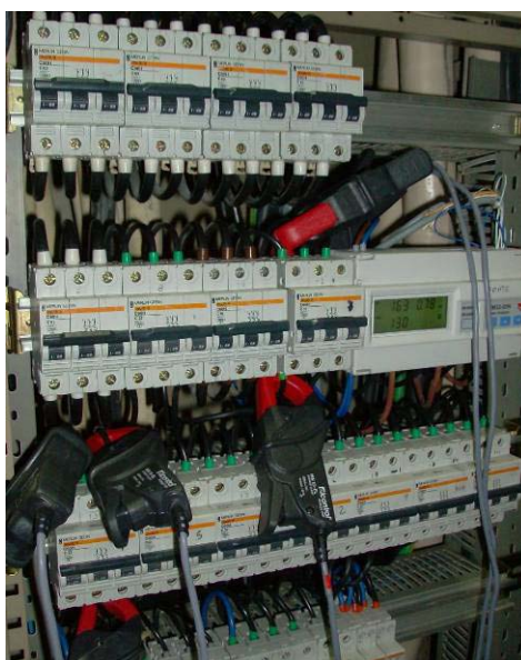
Figura 6.5 - Pormenor da montagem das pinças amperimétricas
