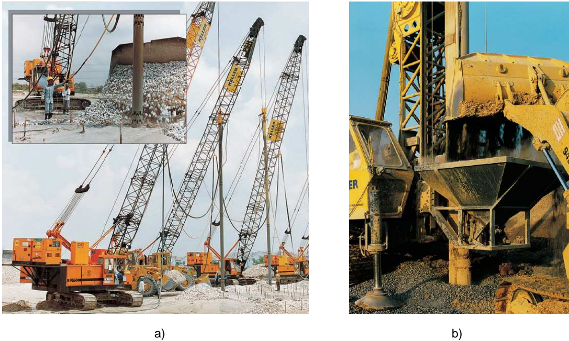
Figura 2.38 – Diferentes métodos de alimentação de brita: a) Alimentação superior – “Top feed method”; b) Vibrador com alimentação na ponta – “Bottom feed method” (Keller 2004)
