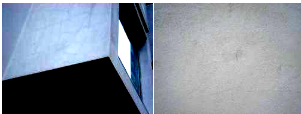
Fig. 33 – (esquerda) Fissuras nas paredes laterais de corpos em balanço [47] e (direita) em zona corrente da parede do r/ chão da fachada Sul [48]
