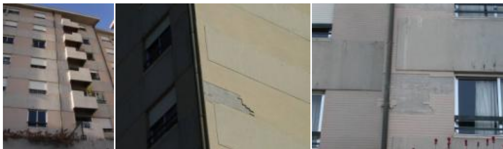
Fig. 26 – Destacamento de elementos cerâmicos do revestimento de fachada [39]
