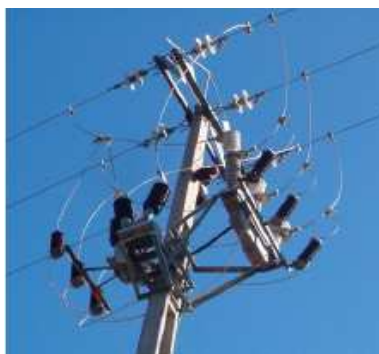
Figura 2.2- Exemplo de um IAR instalado na rede MT[1]
