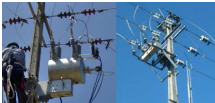
Figura 2.4- Exemplo de OCR2 instalados na rede MT[1].
