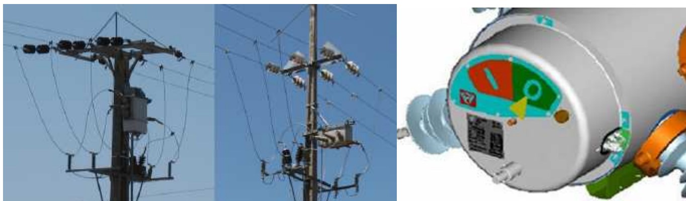
Figura 2.3 - OCR1 instalados na rede de MT e sinóptico mecânico de indicação de estado (aberto ou fechado) [1].
