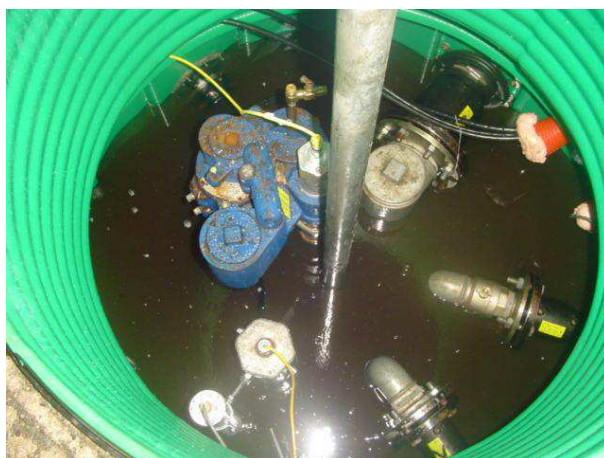
Fig.3.14 – Caixa de visita com problemas de estanquicidade
