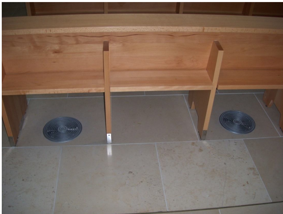
Figura 5.4. – Pormenor dos ventiladores no piso com ruído anormal [Foto do Autor]
