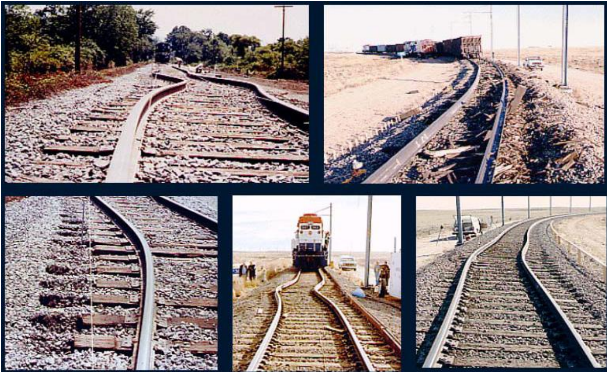
Fig. 1.1 – Exemplos de encurvadura lateral da via-férrea (VNTSC, 2003)
