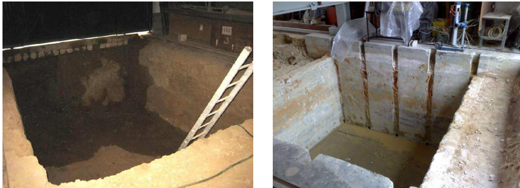
Figura 5. 2: a) “Fossa” sem paredes de betão; b) “Fossa” com paredes envolventes de betão (adoptado de LNEC, 2010)
