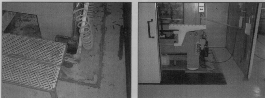
Figura 5.14 – Chapa Antiderrapante no Chão de Cabine Degradada
