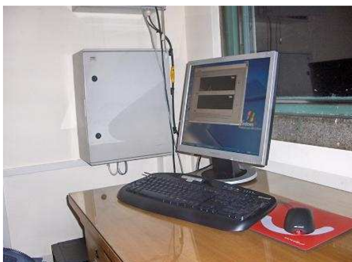
Figura 4.12 – Computador onde é efectuado o controlo do sistema e o armazenamento dos dados, nos escritórios da central da barragem.
