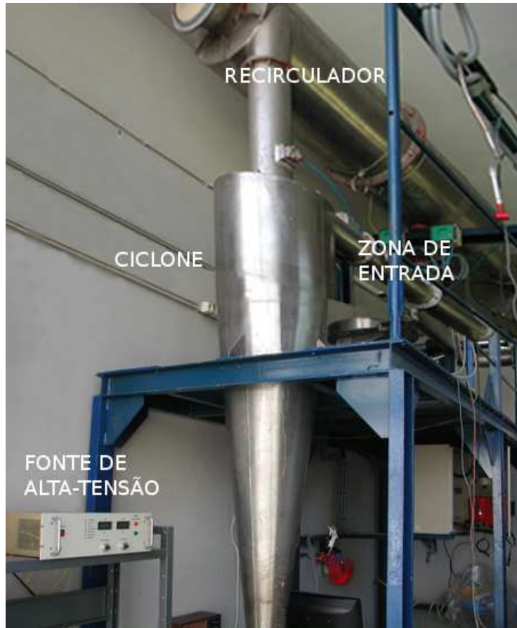
Figura 5.1 Fotografia da instalações piloto e identificação dos componentes principais do sistema
