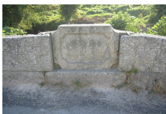
Fig. 2.11 – Ponte de Espindo – silhar no guarda-corpos jusante.
