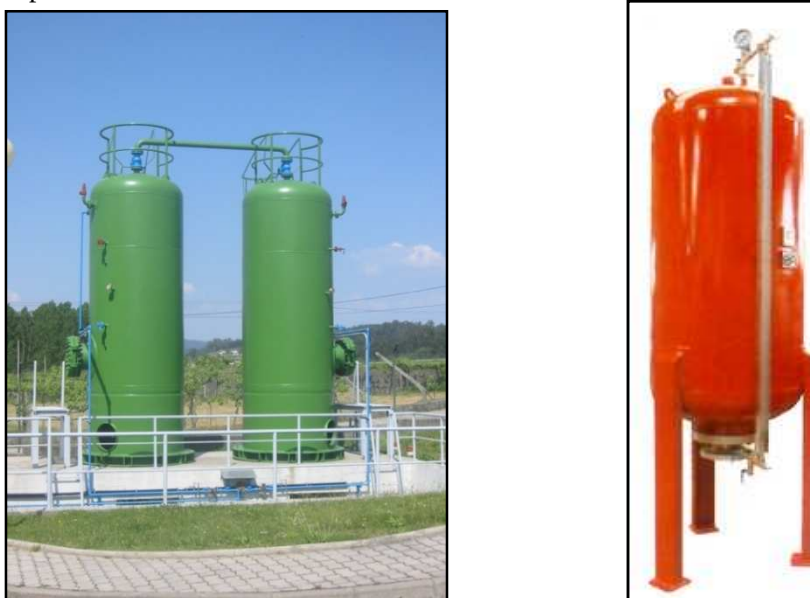
Figura 2.10 – Reservatórios de Ar Comprimido (fonte: Águas do Cávado, SA e Ibaiondo, www.ibaiondo.com )
