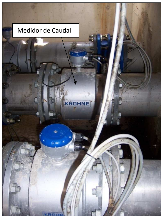
Figura 5.7 – Medidor de Caudal na Conduta Elevatória
