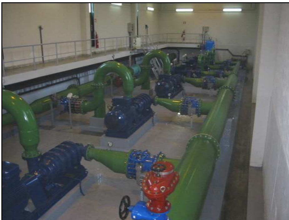
Figura 2 6 – Estação Elevatória de Abastecimento de Água – Exemplo (fonte: Águas do Cávado,SA)
