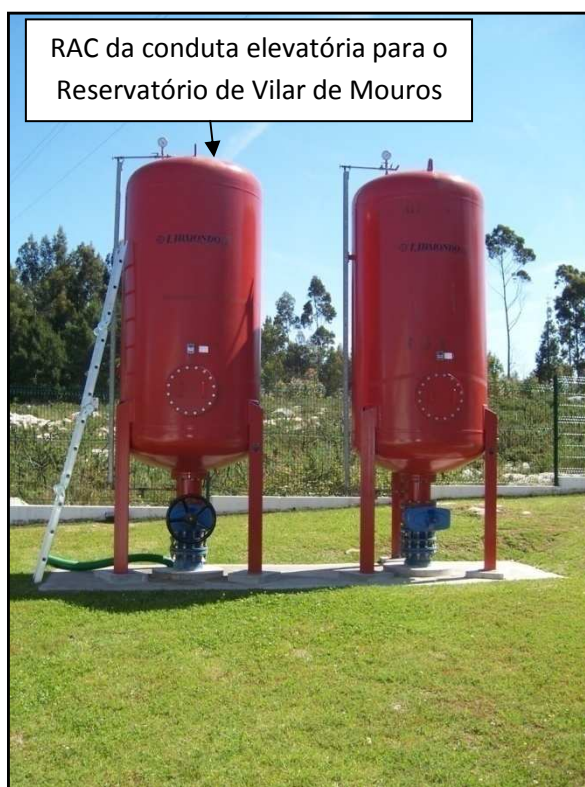
Figura 5.9 – Reservatório de Ar Comprimido
