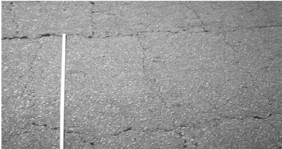
Fig.7 – Fendilhamento tipo “pele de crocodilo” num pavimento
