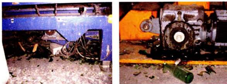
Figura 41 - Estado inicial dos equipamentos das linhas de embalagem
