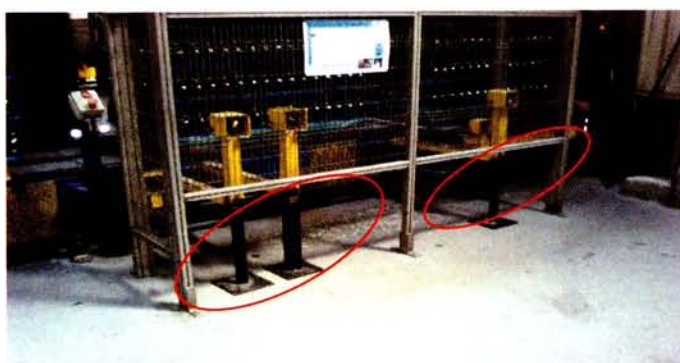
Figura 53-Estado final dos suportes para os sensores
