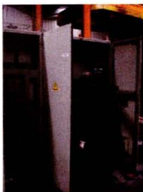
Figura 47-Limpeza de quadros eléctricos
