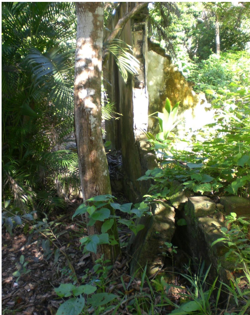
Foto 20: Ruínas da Casa-grande do Engenho Jaguaribe. Autor: Mércia Carréra.
