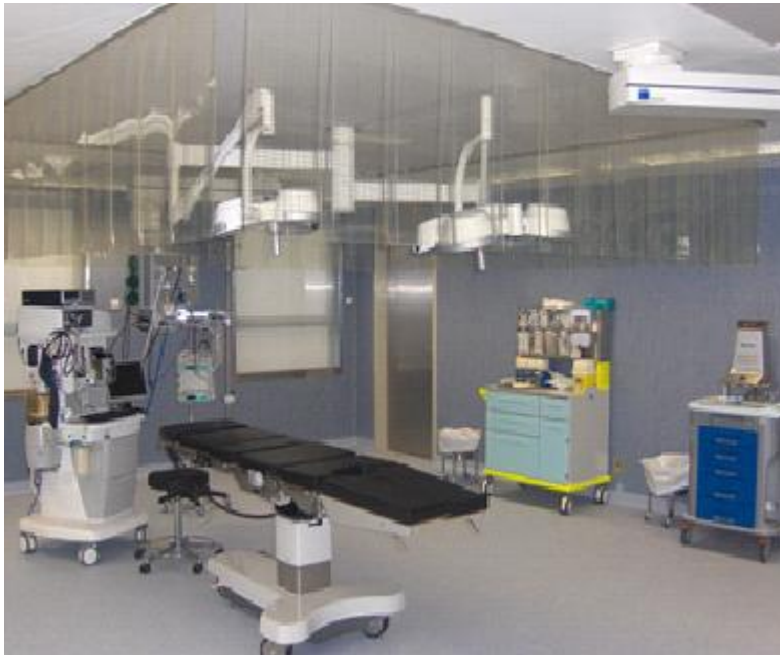
Figura 7 – Bloco Operatório da Unidade de Queimados.
