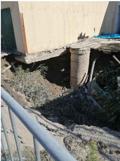
Figura 4 - Situação existente após aluimento das infraestruturas. | Fonte: Francisca Pinto (Neoturf)
