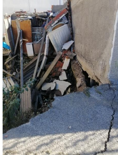
Figura 3 - Situação existente após aluimento das infraestruturas. | Fonte: Francisca Pinto (Neoturf)
