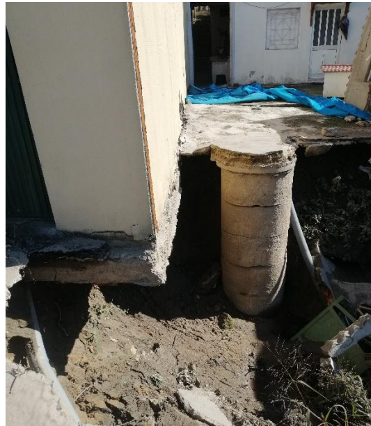
Figura 37 - Situação Existente após aluimento das infraestruturas | Fonte: Francisca Pinto (Neoturf)
