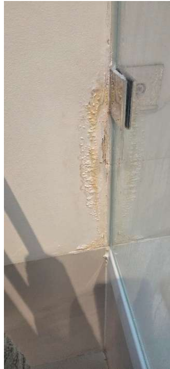
Figura 30 - Infiltração em parede interior - Caso de estudo 2
