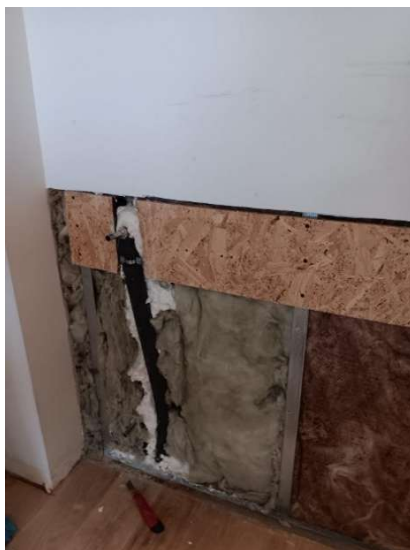
Figura 31 - Infiltração em AVAC - Caso de estudo 4
