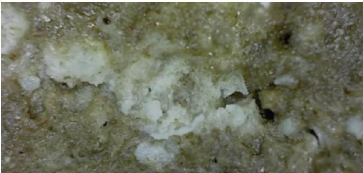
Figura 35 - Cristalização da fissura após entrada de água no elemento estrutural (Fonte: Consultor da marca, 2026)
