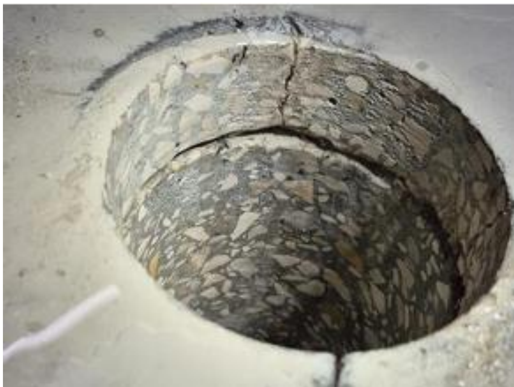
Figura 17 - Evidência da fendilhação existente apenas no revestimento e não na laje (Fonte: Relatório de inspeção, 2025)
