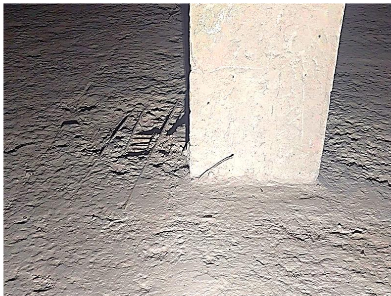
Figura 23 - Patologia da laje de pavimento 1 (Fonte: Registo fotográfico STAP, 2025)
