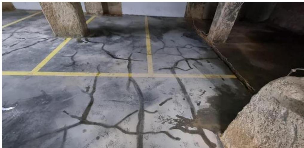
Figura 21 - Padrão de fendilhação intensa numa área do piso -1 (Fonte: Relatório de inspeção, 2025)
