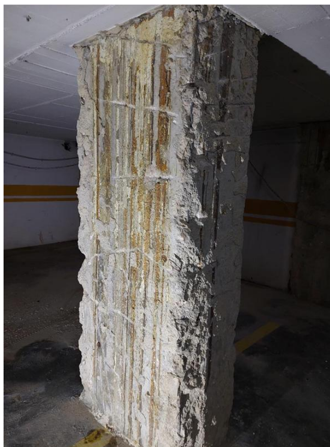
Figura 29 - Pilares sem revestimento e sem recobrimento (Fonte: Relatório de inspeção, 2025)
