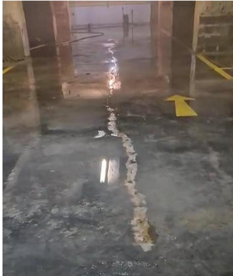
Figura 20 - Fendilhação a meio vão na face superior da laje (Fonte: Relatório de inspeção, 2025)
