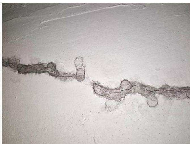
Figura 19 - Reabertura de fenda sobre o selante (Fonte: Relatório de inspeção, 2025)
