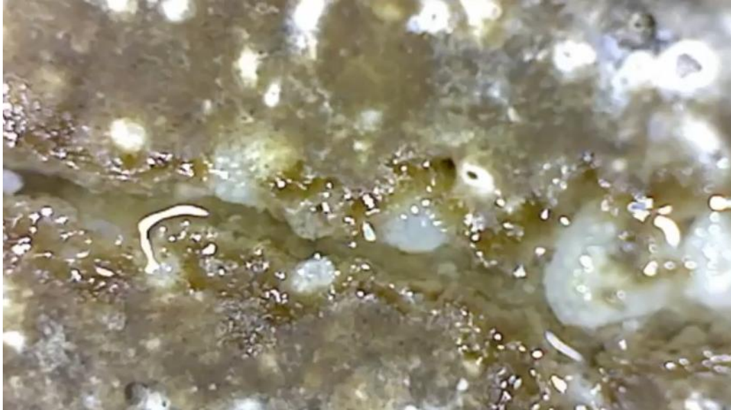
Figura 34 - Entrada de água nas fissuras com material de origem espanhola (Fonte: Consultor da marca, 2026)
