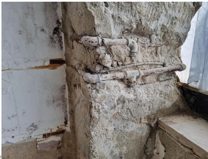
Figura 28 - Armadura exposta (Fonte: Relatório de inspeção, 2025)
