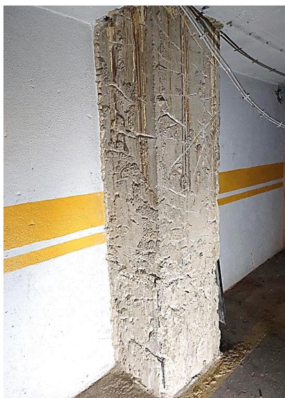
Figura 27 - Pilares sem revestimento e sem recobrimento (Fonte: Relatório de inspeção, 2025)
