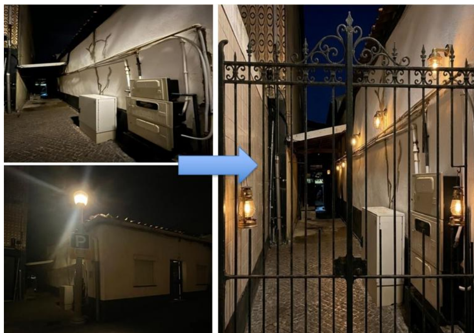
Figura 16 - Portão de entrada e sistema de iluminação
