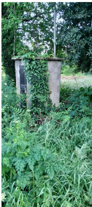
Figura 32 – Cabine de motor eléctrico de rega em Romariz, Santa Maria da Feira. Registo de Abril de 2026
