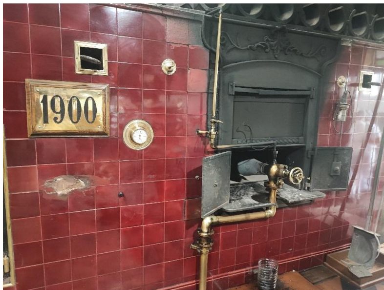
Figura 75 – Queimador a gásóleo posicionado para aquecimento do forno. (Imagem de autoria própria, fotografada a 5 de junho de 2025)
