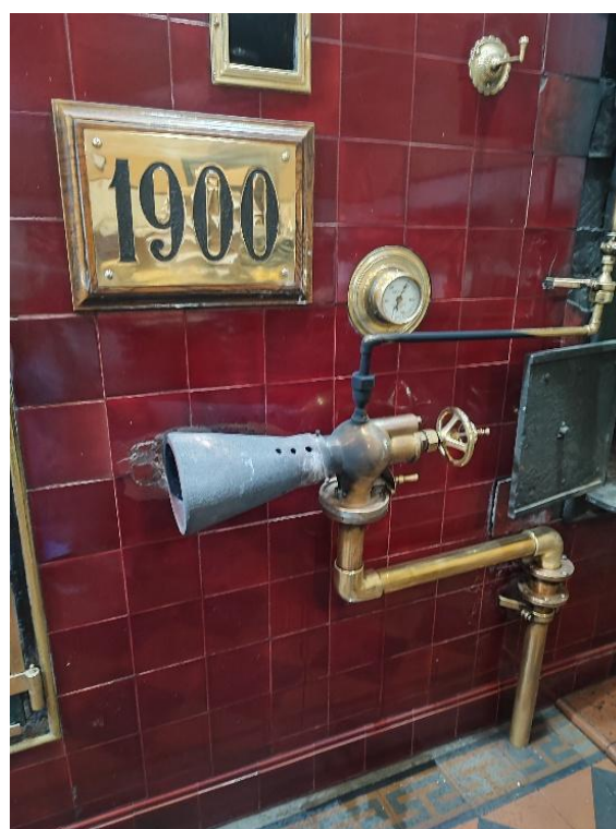
Figura 76 – Queimador a gásóleo. (Imagem de autoria própria, fotografada a 5 de junho de 2025)
