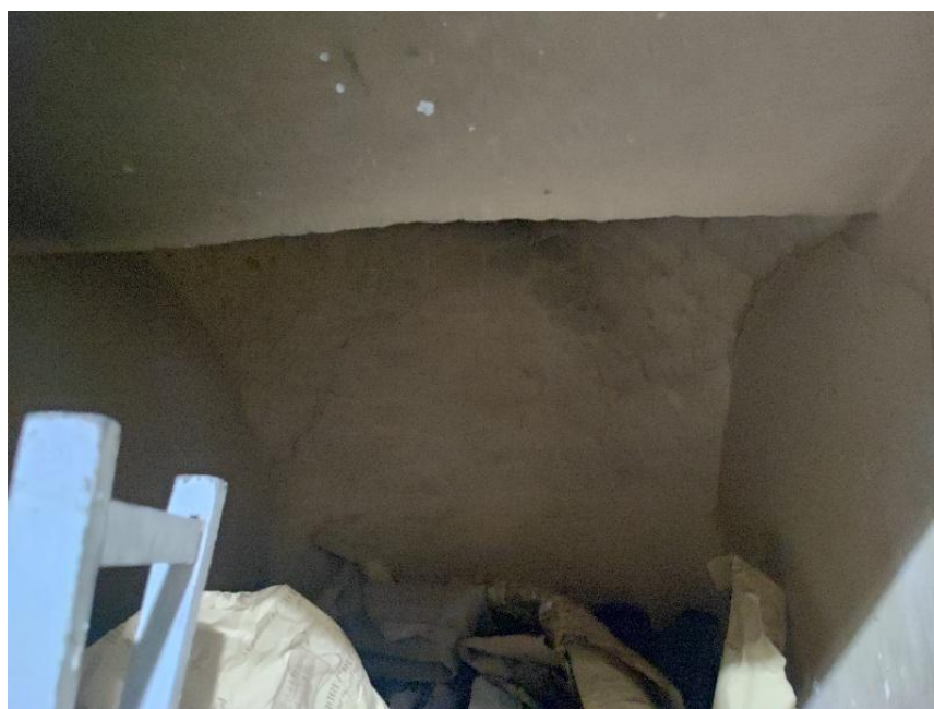
Figura 74 – Interior do forno central (encontra-se inoperável). (Imagem de autoria própria, fotografada a 5 de junho de 2025)
