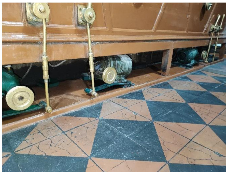
Figura 52 – Motores elétricos instalados nos engenhos. (Imagem de autoria própria, fotografada a 30 de janeiro de 2026)
