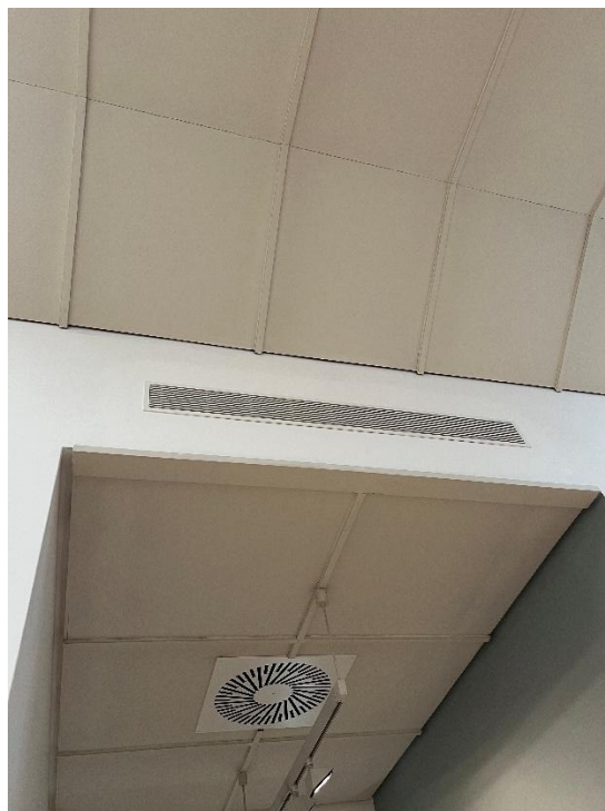
Figura 50: Sistema de climatização do edifício. © Martins, 03/12/2025.
