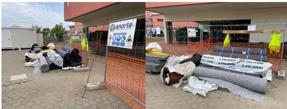
Figura 46 - Organização do estaleiro sem identificação de materiais
