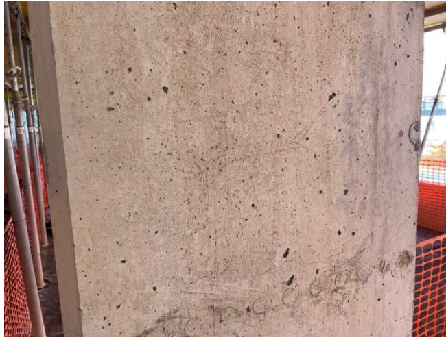
Figura 33 - Presença de bolhas na superfície do betão
