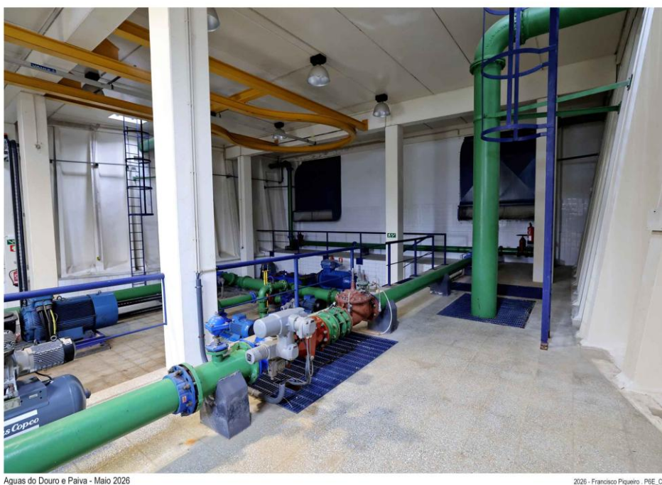
Fig. 6.7 - Registo fotográfico do ramal atual da EE de São Vicente de Louredo, com especial relevo para a Válvula Redutora de Pressão (VRP).
