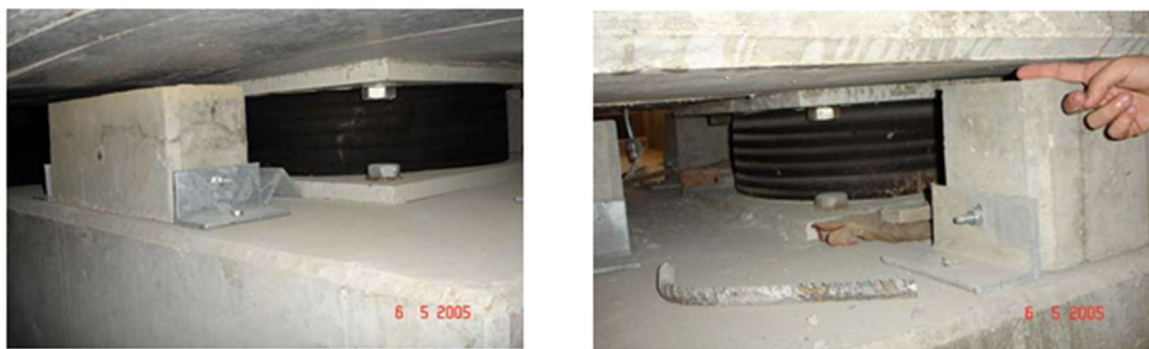
Fig. 24 – Apoio de borracha de alto amortecimento utilizado no Hospital da Luz [30]
