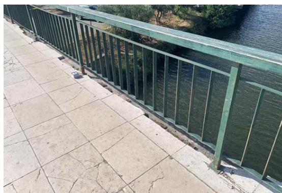
Figura 3.12 - Fissuração da pedra de revestimento dos passeios e destacamento no bordo do tabuleiro.
