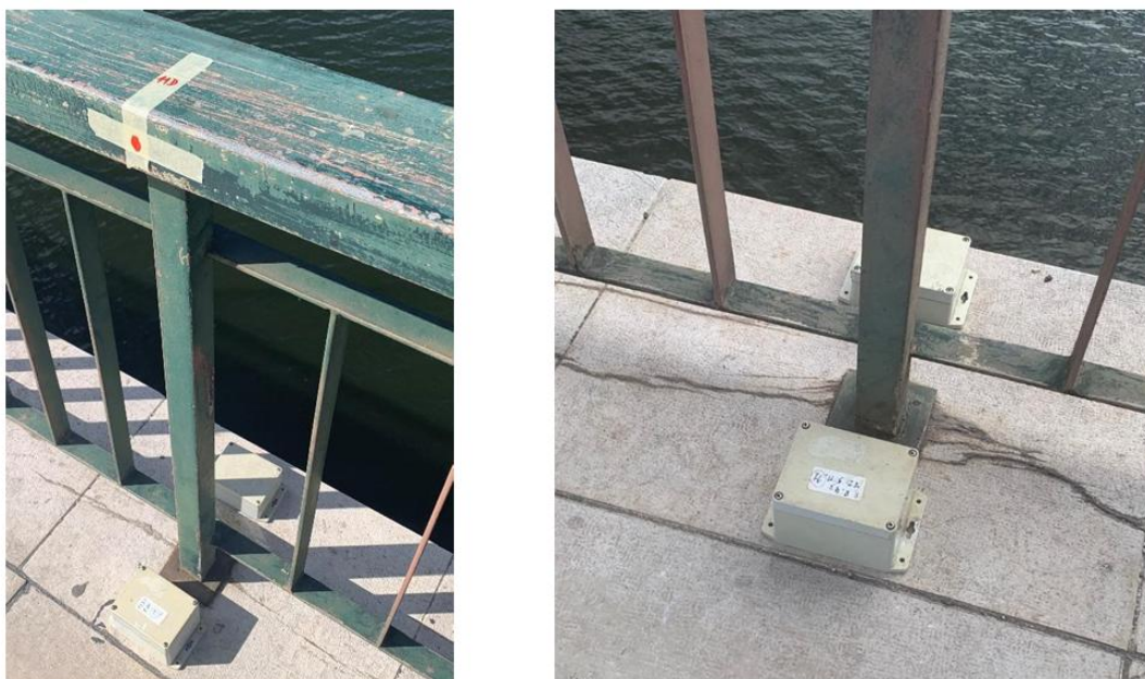
Figura 4.2 - Vista de sensores instalados na ponte para monitorização contínua.
