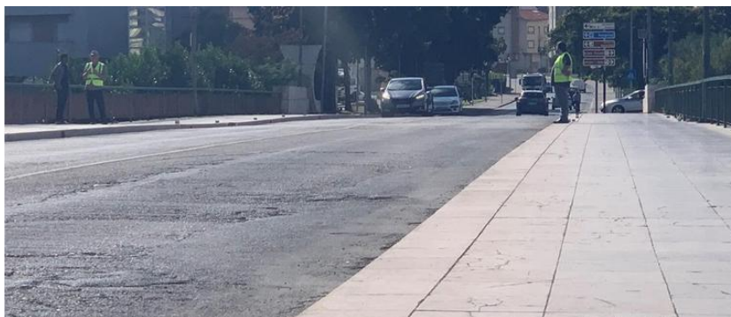
Figura 3.11 - Observação do desalinhamento do tabuleiro.
