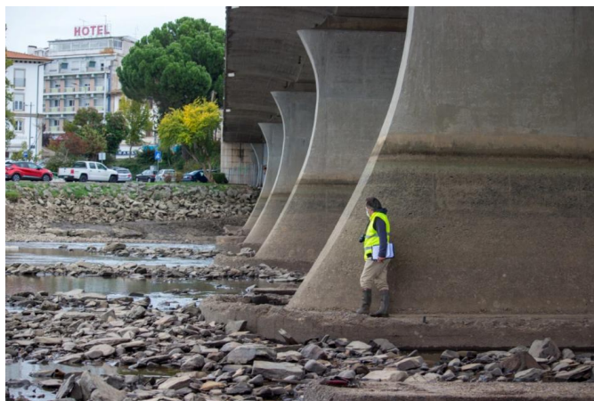
Figura 3.10 - Estado atual dos pilares da ponte (com o nível do rio tua baixo)
