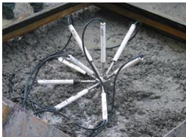
Figura 2.13 - Grupo de extensómetros de resistência elétrica (Mendes 2023).
