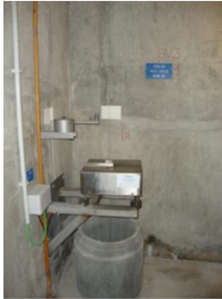
Figura 2.9 - Vista da base de coordenómetro do fio de prumo (LNEC 2025).
