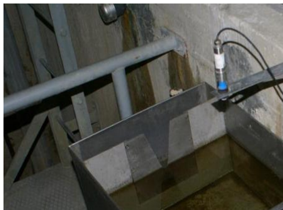
Figura 2.15 - Bica totalizadora com medidor (Mata 2007).
