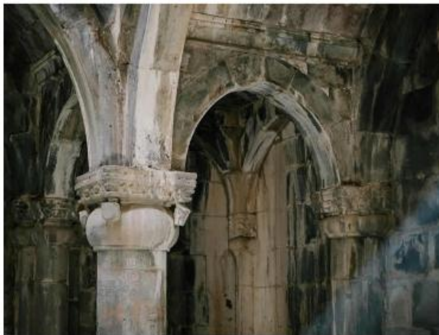
Figura 2.8 - Cristalização de sais, Construção Magazine, 16 de Março de 2026, https://www.construcaomagazine.pt/
