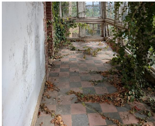
Figura 3.8 – Deformação do pavimento
