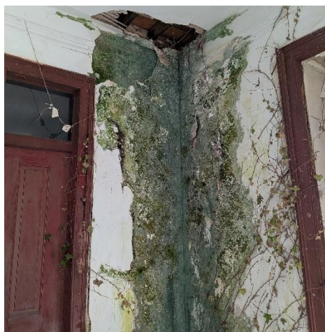
Figura 3.6 – Biodeterioração das alvenarias
