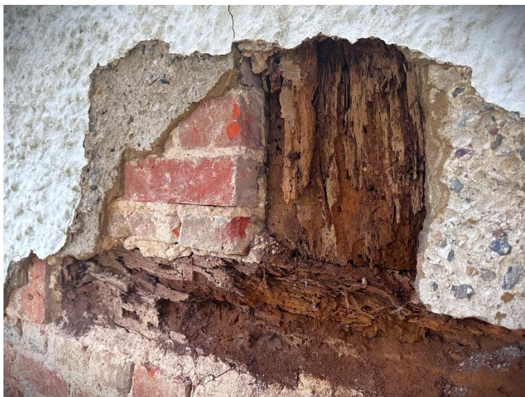
Figura 2.10 - Destacamento de revestimento aplicado em intervenção devido à incompatibilidade das matérias, M. WOMERSELEYS, 16 de Março de 2026, https://www.mwomersleys.co.uk/
