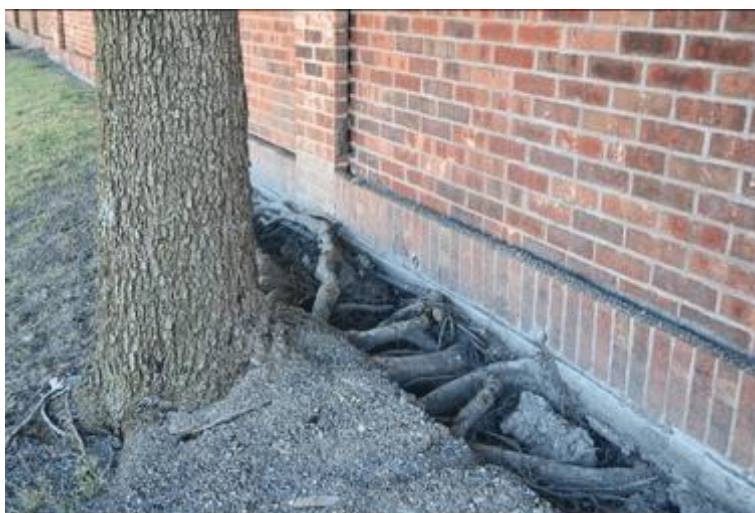
Figura 2.11 - Danos mecânicos devido ao desenvolvimento das raízes, cvviewprojects, 16 de Março de 2026, https://www.cvviewprojects.com.au/
