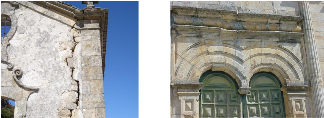
Figura 2.3 - Abertura de juntas (esquerda); Deslizamento relativo entre blocos (direita)
