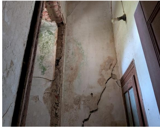
Figura 3.7 – Fissuração em parede de alvenaria
