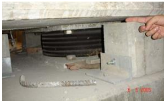
Figura 22- Dispositivos de Apoio HDRB usados na Base do Hospital da Luz (Ferreira (n.d.))
