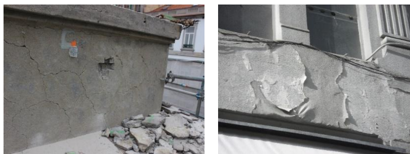
Figura 3. Fissuração do suporte e destacamento da pintura das fachadas do Mercado do Bolhão.
