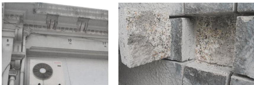
Figura 5. Localização dos ensaios 8, 10 e 11 e do tipo de rotura obtido no ensaio 11.
