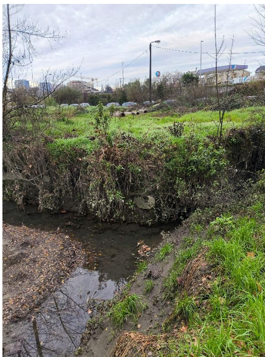
Figura 52 – Descarga do coletor de águas pluviais
