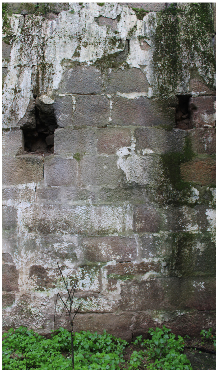
049 Lacunas no interior da nave da parede sul Fotografia da autora, 2023
