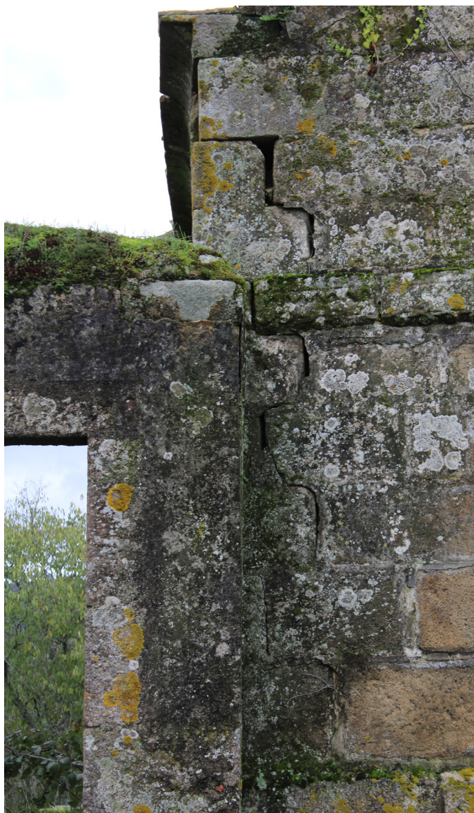
043 Fenda na interseção da parede nascente e sul da capela Fotografia da autora, 2024
