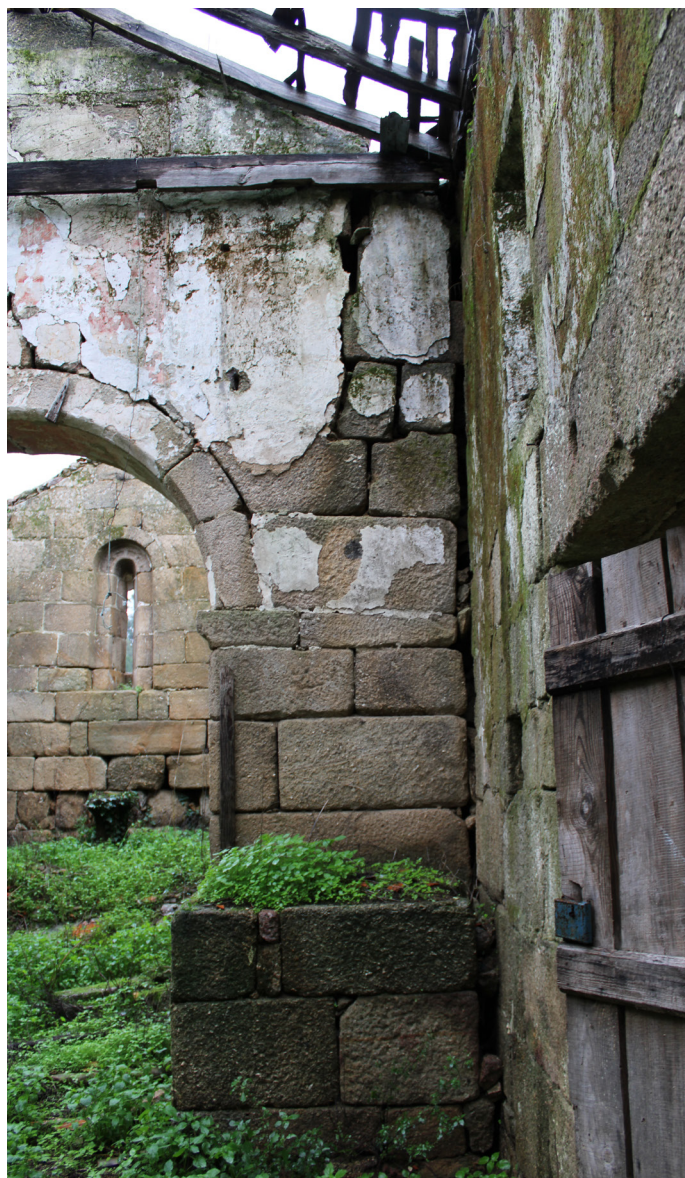
044 Fenda na interseção do arco com a parede sul da nave Fotografia da autora, 2024
