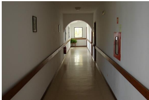
Figura 3.15 - Corredor com meios de primeira intervenção de combate a incêndio [foto de J. Renda]
