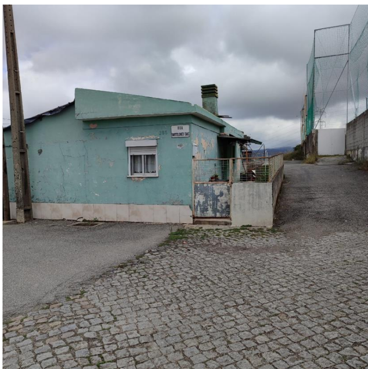
Anexo 21 - Edifício degradado na rua Bartolomeu Dias, União de freguesias de Campo e Sobrado (Campo)
