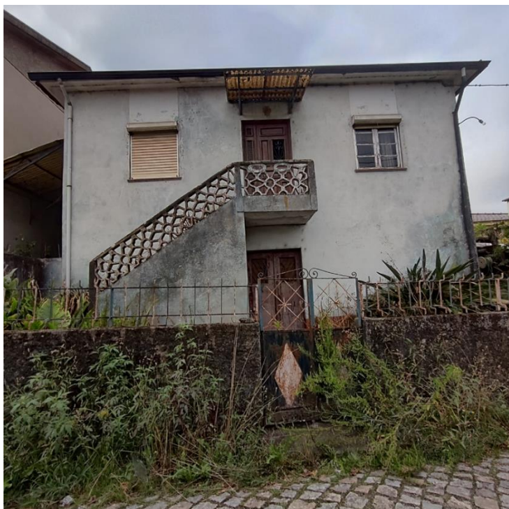
Anexo 23 - Edifício degradado na rua de Luriz, União de freguesias de Campo e Sobrado (Campo)
