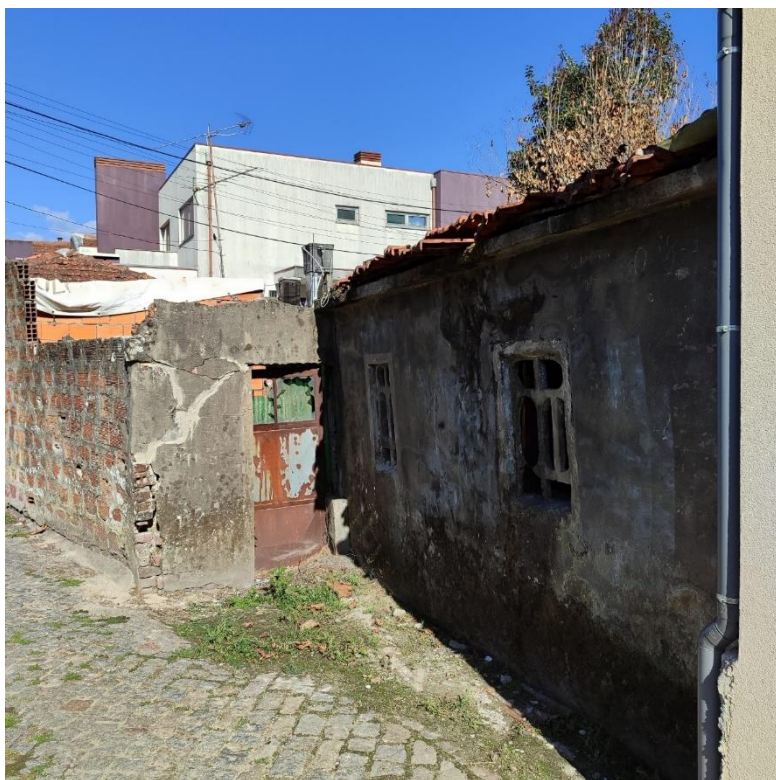
Anexo 9 - Edifício degradado na rua das Arregadas, freguesia de Ermesinde
