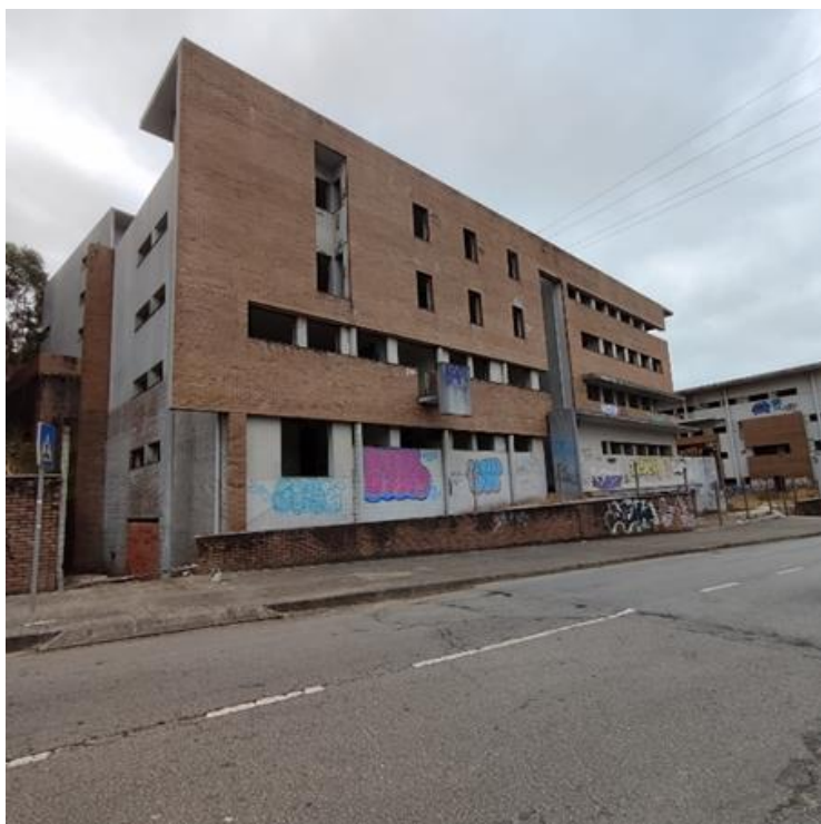
Anexo 17 - Edifício degradado na rua Vasco de Lima Couto, freguesia de Valongo
