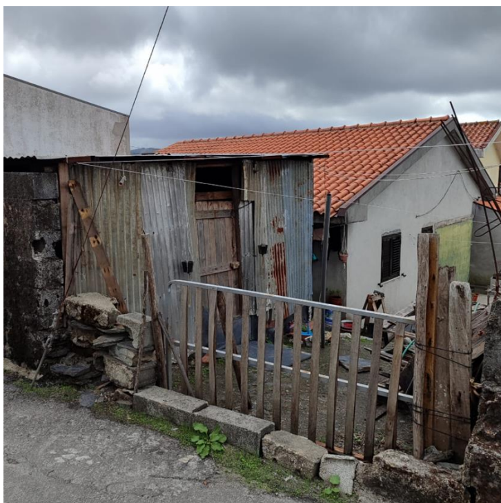
Anexo 25 - Edifício degradado na travessa dos Desportos, União de freguesias de Campo e Sobrado (Campo)
