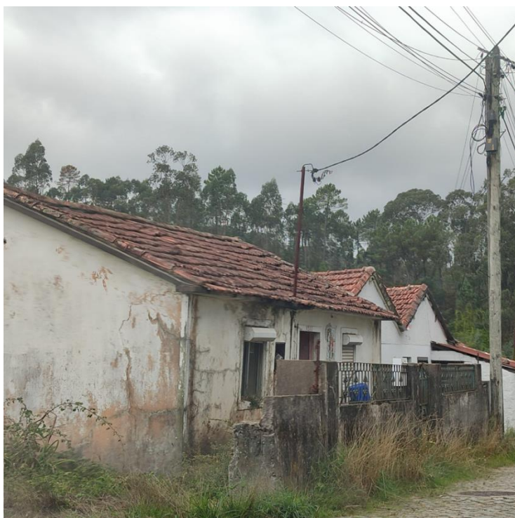
Anexo 28 - Edifício degradado na rua da Aldeia, União de freguesias de Campo e Sobrado (Sobrado)
