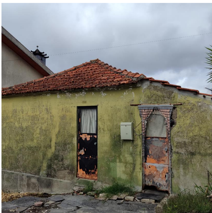
Anexo 22 - Edifício degradado na rua Bartolomeu Dias, União de freguesias de Campo e Sobrado (Campo)
