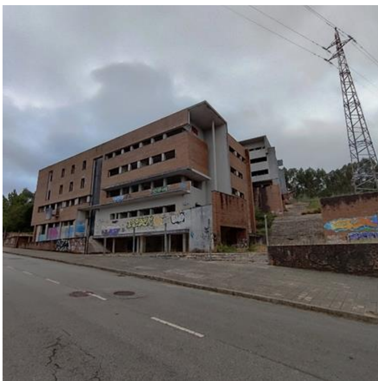
Anexo 16 - Edifício degradado na rua Vasco de Lima Couto, freguesia de Valongo
