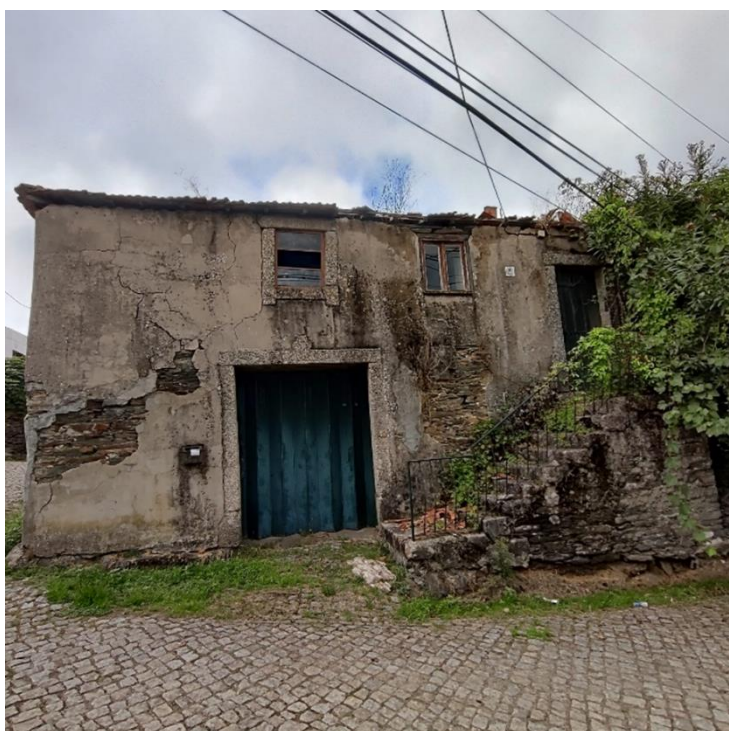
Anexo 24 - Edifício degradado na rua Tristão Vaz Teixeira, União de freguesias de Campo e Sobrado (Campo)
