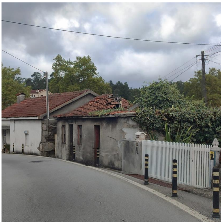
Anexo 20 - Edifício degradado na estrada Nacional 209, União de freguesias de Campo e Sobrado (Campo)
