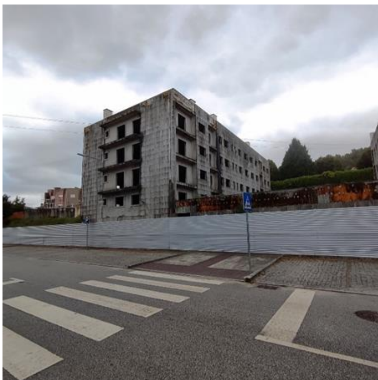
Anexo 14 - Edifício degradado na rua Regedor José Diogo, freguesia de Valongo
