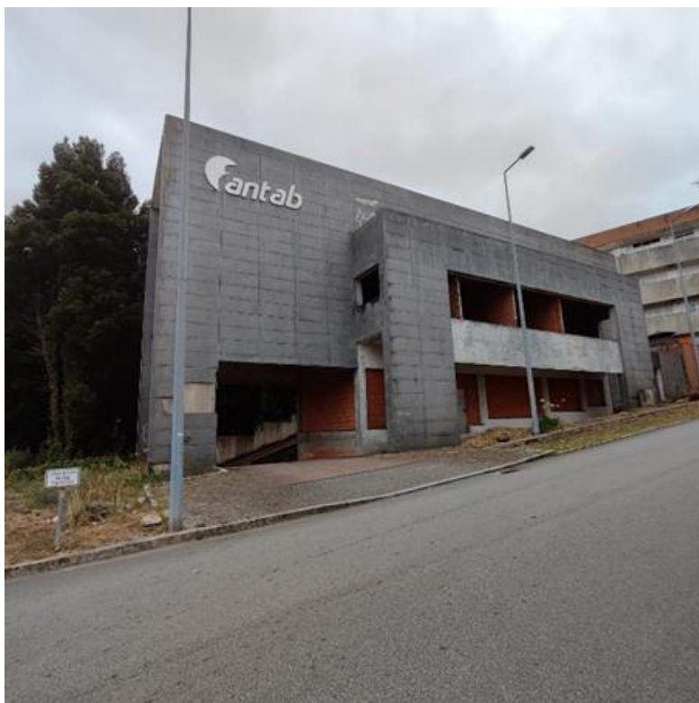
Anexo 19 - Edifício degradado na travessa Nuno Tristão, freguesia de Valongo
