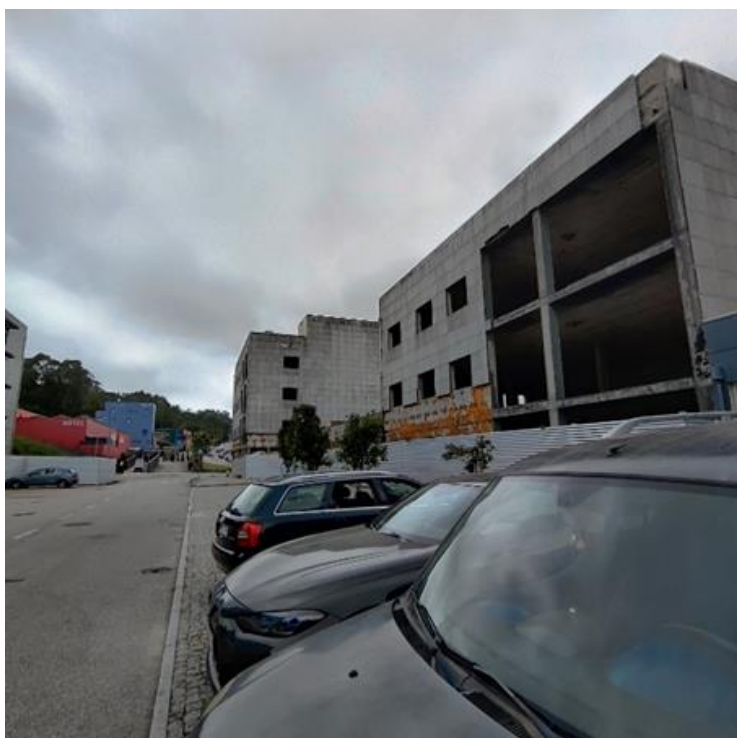
Anexo 12 - Edifício degradado na rua Regedor José Diogo, freguesia de Valongo
