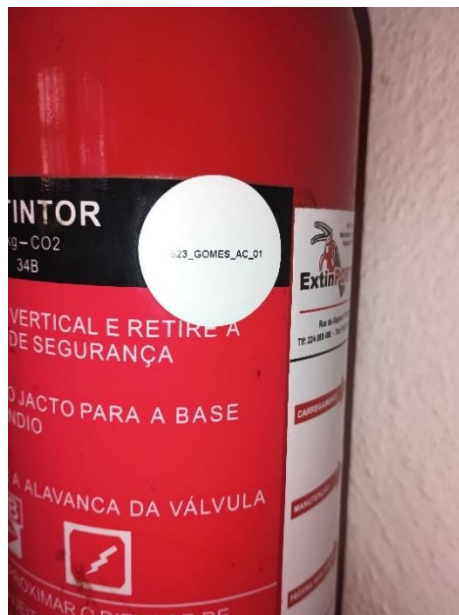
Figura 16 - Extintor da Escola Básica 2/3 Gomes Teixeira
