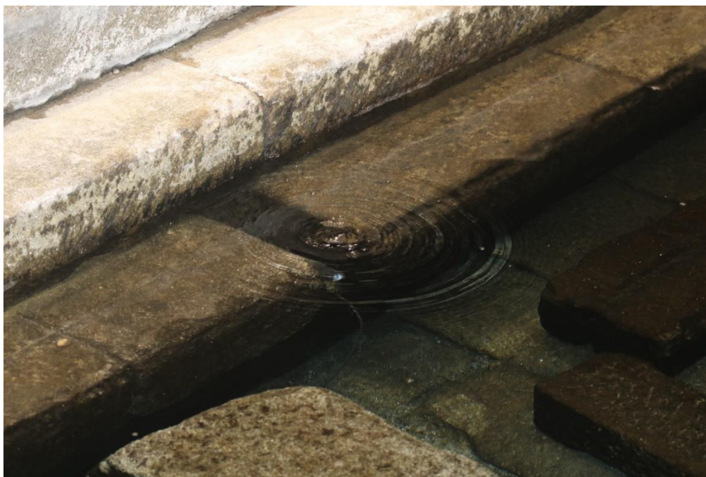
Anexo 1 - Figura 61- Nascente no fundo da piscina B, (Fotografia de autor)
