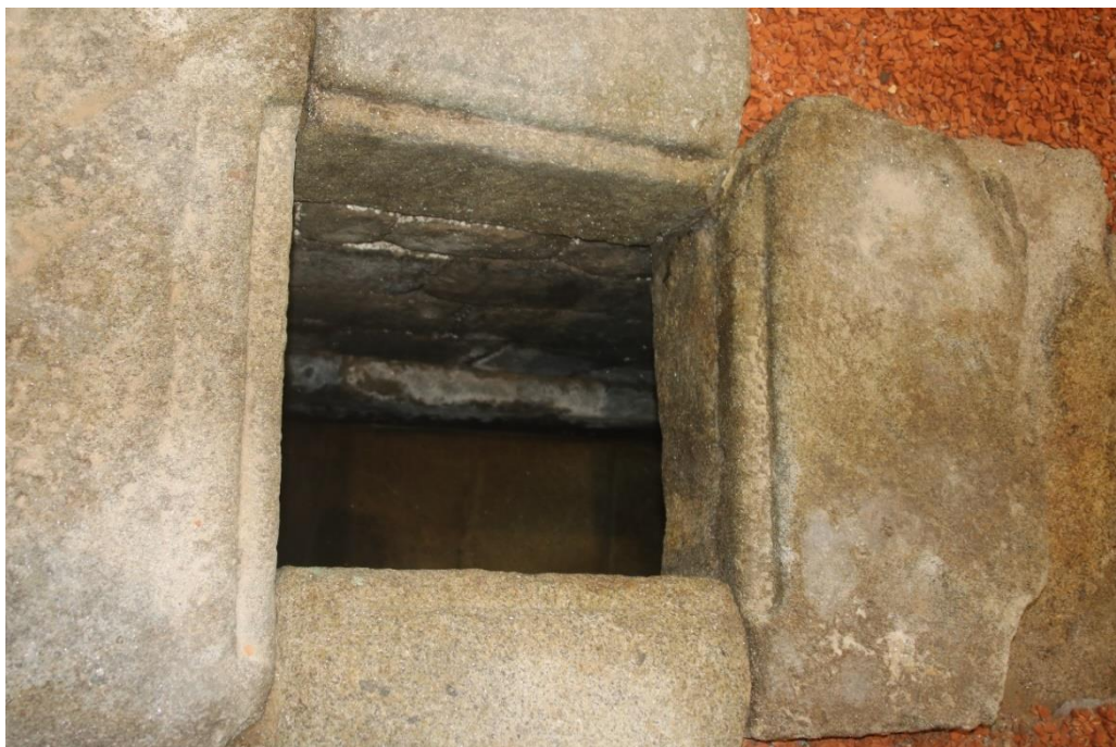
Anexo 1 - Figura 66- Interior do poço de inspeção e derivação, (Fotografia de autor)
