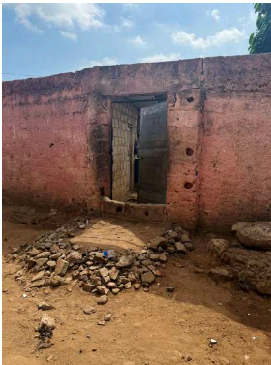
Fig. 91. Proteção da entrada através de um muro e pedras, impedindo que a chuva e o lixo entrem.
