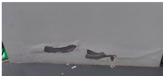
Figura 27- Sinais de infiltração numa parede da Reserva 2. © Inês Batista, 2025.
